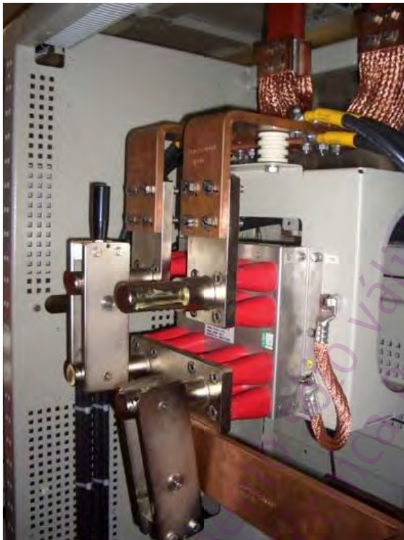
Figura 1-8. Seccionadores de pantógrafos
