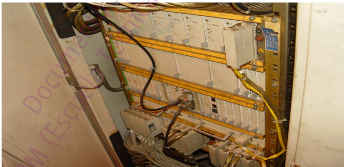
Figura 1-18. Detalle sistema de control motor síncrono Sibas S/252.
