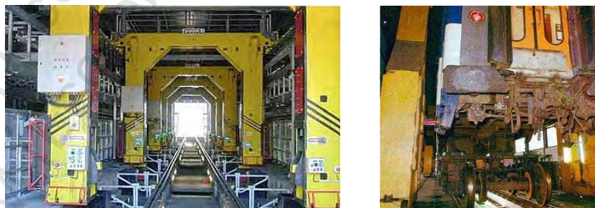
Figura. 4-2 Instalaciones para cambio de bogies de diferente ancho
