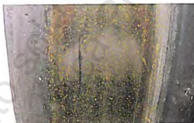
Fisura longitudinal superficial
