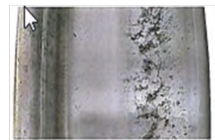
Desprendimientos mas profundos
